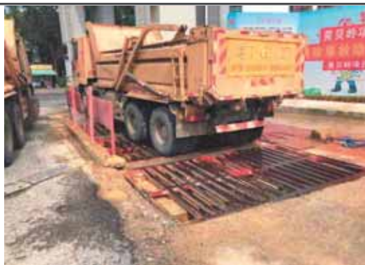
主出入口洗车池
