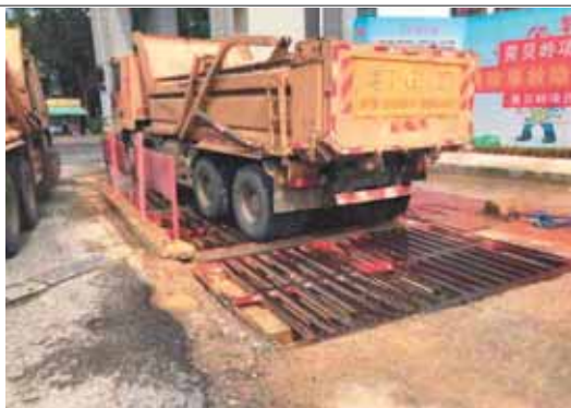
主出入口洗车池
